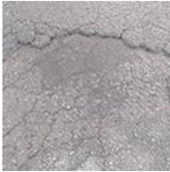
はく離・水溜まり
