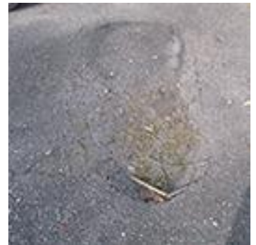
不等沈下(陥没)
